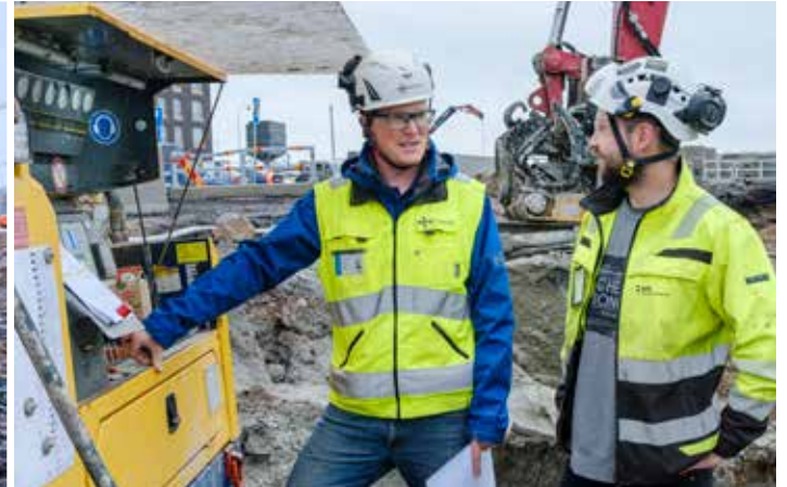
KFS Finland Oy:n kehityspäällikkö Matti Virolainen (vas.) ja Samuli Kiuru
